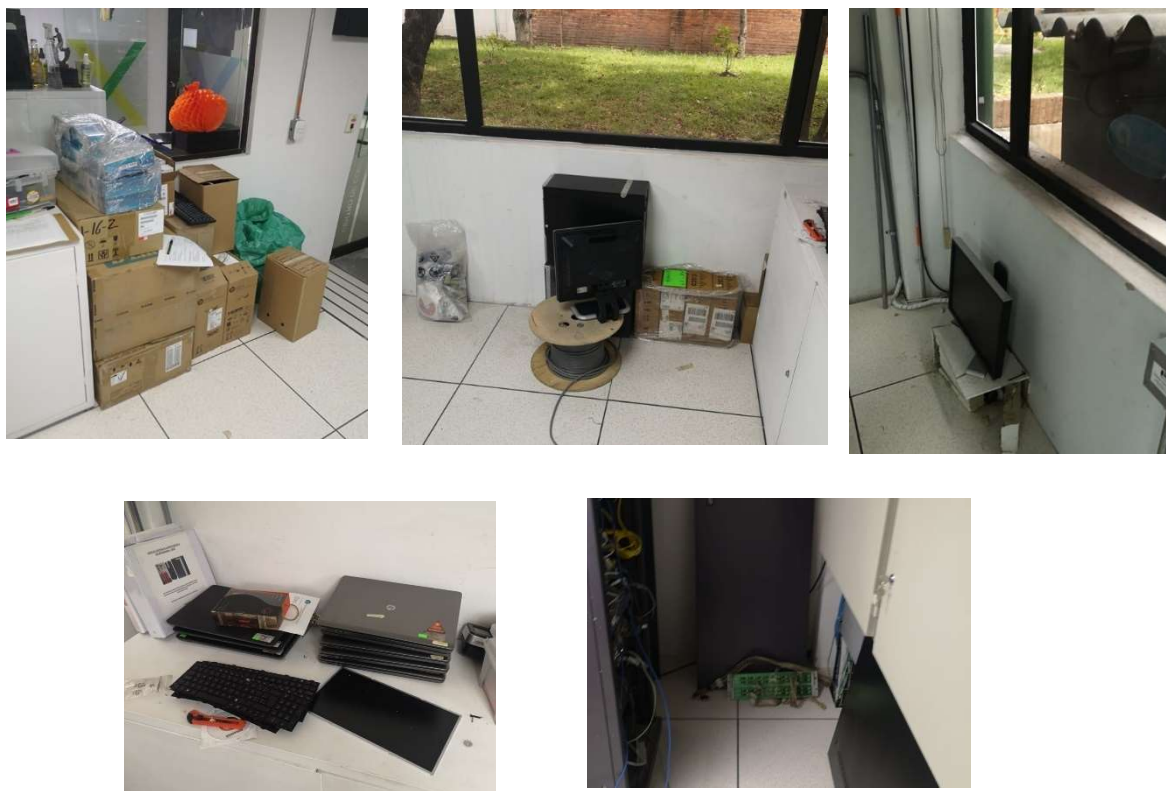
Ilustración 1 Material Inflamable en el Centro De Cómputo
