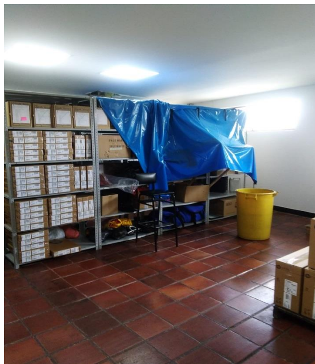
Imagen No. 9 Filtraciones Fuente: Bodega Almacén IDPAC
