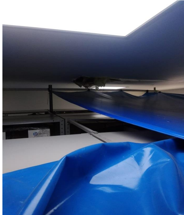
Imagen No. 8 Filtraciones Fuente: Bodega Almacén IDPAC
