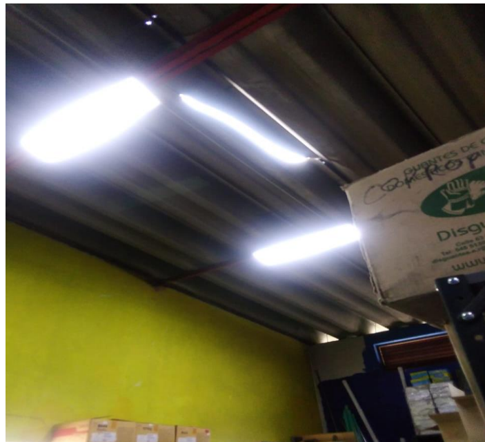
Imagen No. 7 Filtraciones Fuente: Bodega Almacén IDPAC
