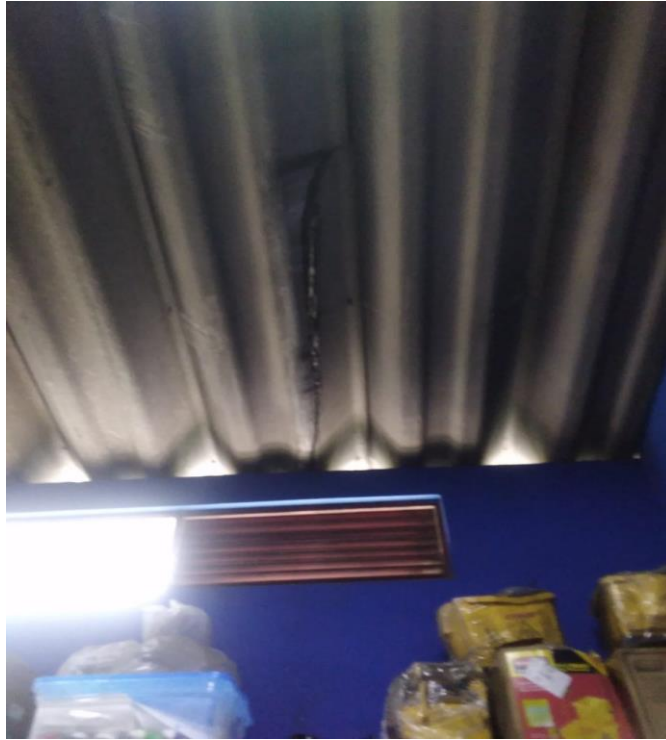
Imagen No. 6 Filtraciones Fuente: Bodega Almacén IDPAC
